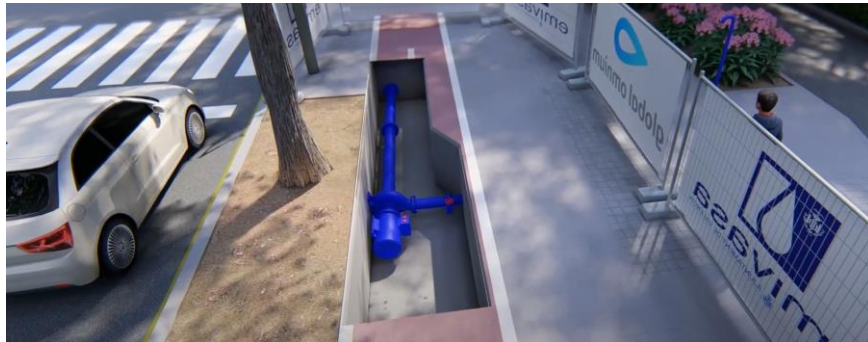
Figura 4. Turbina instalada en la AV. Cortes Valencianas.
